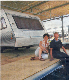
Brenda Zwiwels-van Vliet en haar broer Ton bij hun hal in aanbouw. FOTO JACQUES ZORGEMAN
